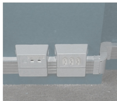
Sistema Dutotec aplicado em escritório.
