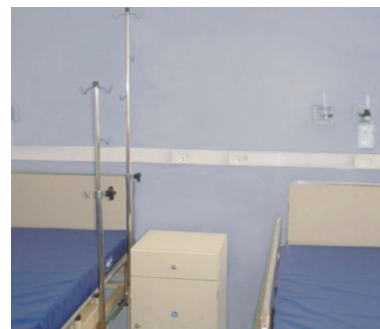
Aplicação do sistema Dutotec em hospital.
